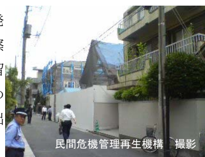
未だに警戒が続く爆発現場 7月13日撮影
